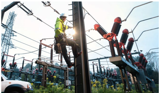
Die Mitarbeiter*innen der LINZ NETZ GmbH garantieren eine sichere Stromversorgung rund um die Uhr.
