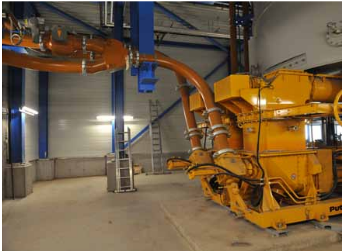
Über zwei Rohrstränge wird der aufbereitete Klärschlamm in den Kraftwerkskessel gepresst.
