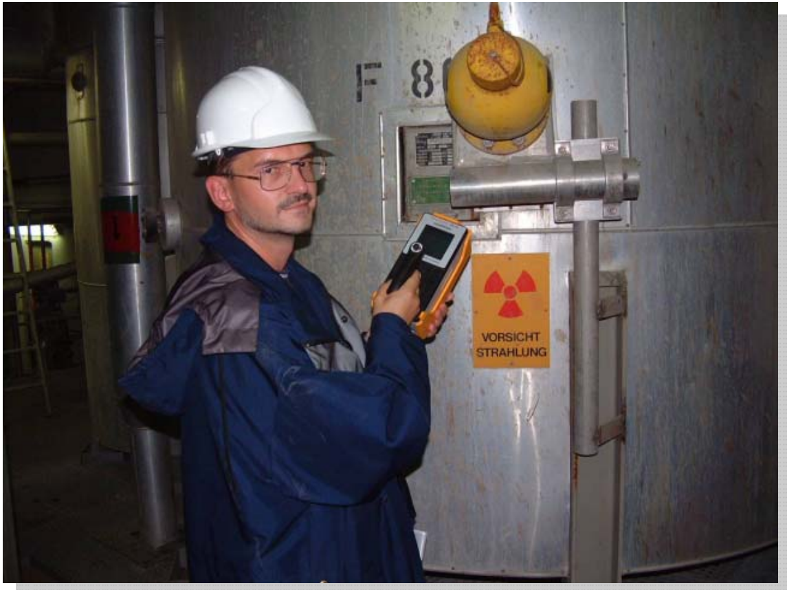
Foto 2: Dosisleistungsmessung einer radioaktiven Füllstandseinrichtung
