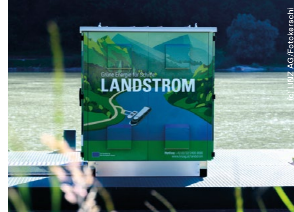
Die Energieterminals, ausgestattet mit präziser Hochleistungstechnik, bilden das Herzstück der Landstrom-Anlagen.
