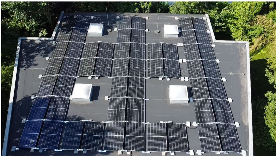
Abb. 9: Photovoltaik-Anlage (54 Module) – Tropenhaus Linzer Tiergarten
