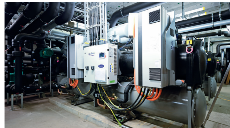
Die Kapazität der Anlage in der Fernkältezentrale wird bis 2023 deutlich gesteigert.
