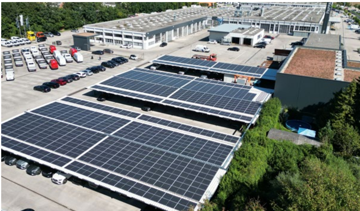
Photovoltaikanlage der Linz AG auf dem Dach der Firma Pappas
