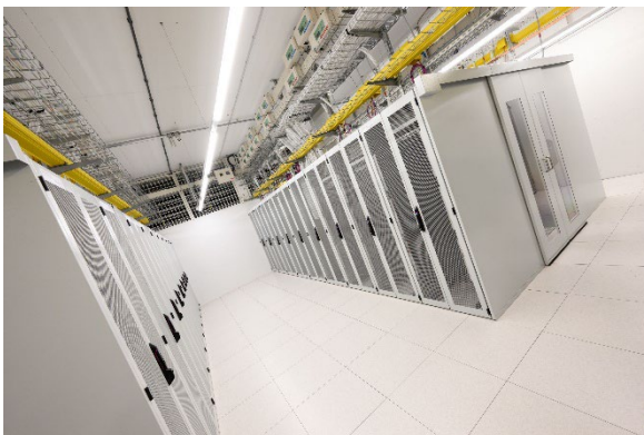
Links: einer der beiden Serverräume
