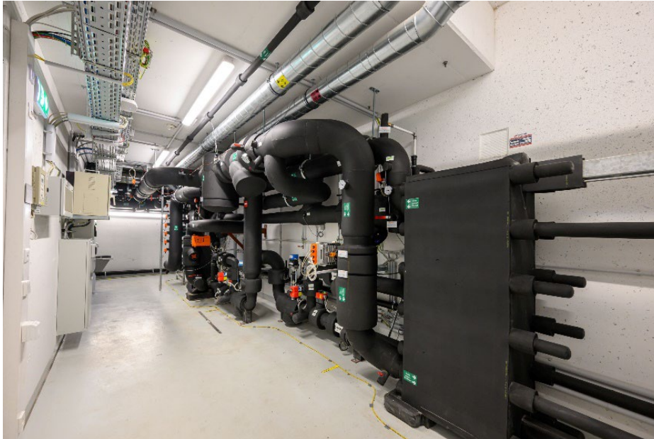
Abb.: Fernkälte-Übergabestation im neuen IT- und Data Center, erstes Untergeschoß. Hinter der Mauer rechts schließt die Kältezentrale der LINZ AG an.
